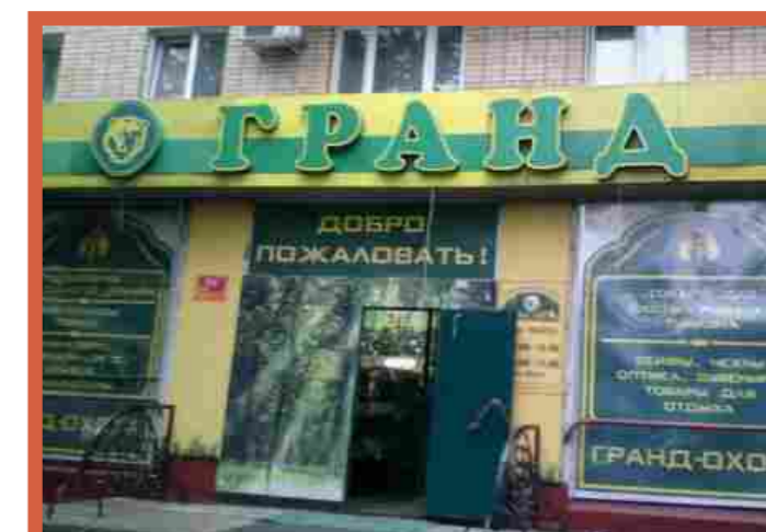
Остекление на двери отсутствует, что не соответствует рекомендациям.
