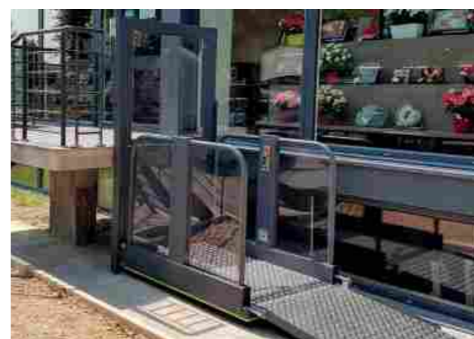
Входная группа оборудована подъемником.
